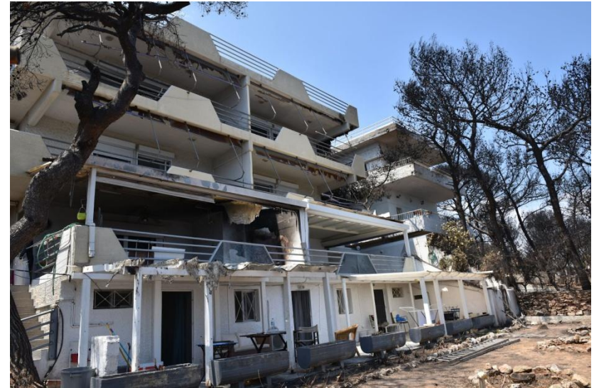
2. Daños ligeros a moderados
